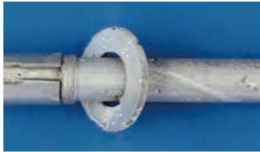
Figura 2: exemplo de corrosão por placas em aço inoxidável.
