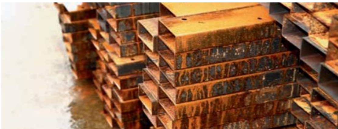
Figura 1: Corrosão no aço.
