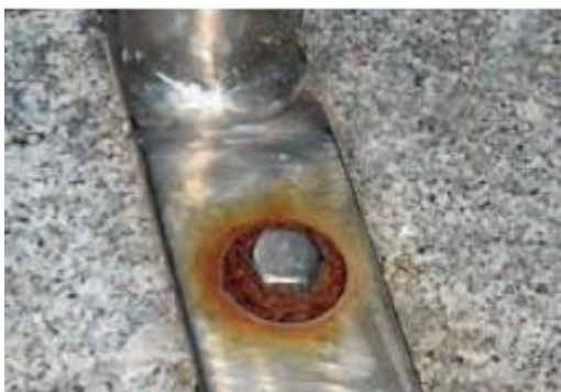
Figura 5: exemplo típico da corrosão galvânica entre metais diferentes (inox e ferro).
